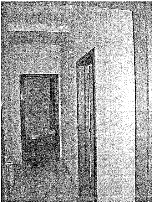
Corridoio al piano primo. Sono assenti i punti luce e alcuni infissi risultano fuori sede.
