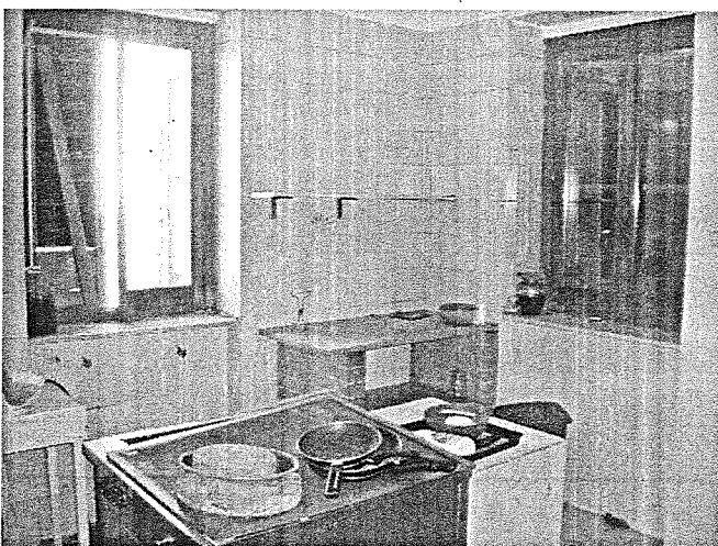
Altra vista della cucina al piano terra con in evidenza gli infissi e i radiatori dello stato di degrado e abbandono in cui versano i locali della parzialmente divelti.
